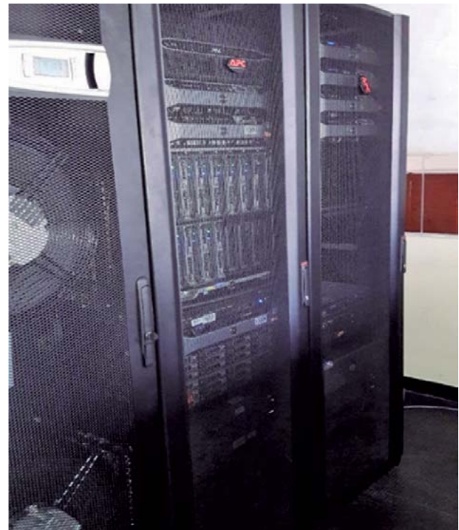
Figura 1.- Clúster computacional de alto rendimiento implementado en el Laboratorio de Modelado Oceanográfico, Ecosistémico y del Cambio Climático (LMOECC)
