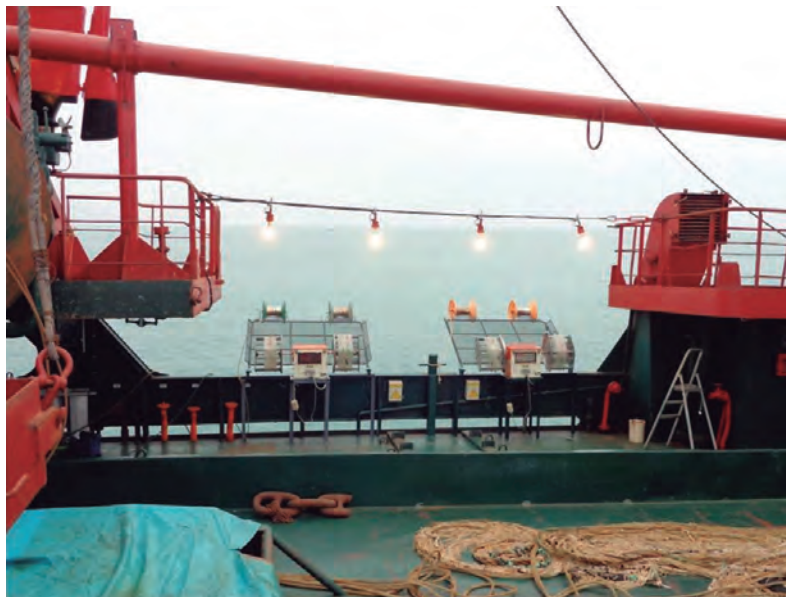
Máquinas automáticas para pesca de calamar, implementada con su luminaria y tableros eléctricos en el BIC Humboldt
