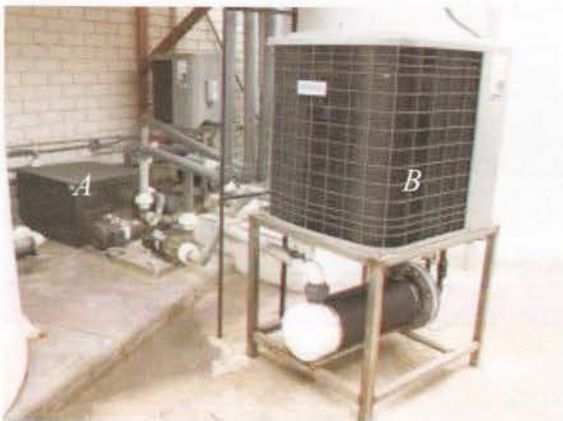
Fig. 73.- Equipos de tratamiento térmico (A) chiller, (B) Bomba de color
