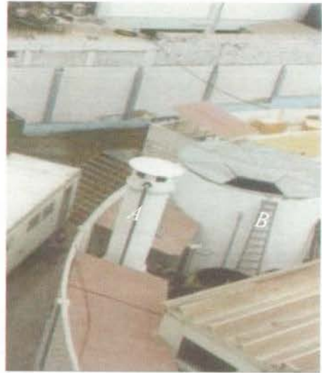
Fig. 72.- Torre de aireación (A), y Tanque de almacenamiento de 50 m 3 de capacidad (B)
